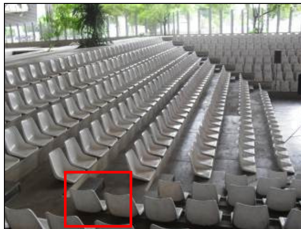
Figura 11. Assentos do Teatro de Arena – degrau improvisado, que causa desconforto. Fonte: Arquivo pessoal, 2010.
