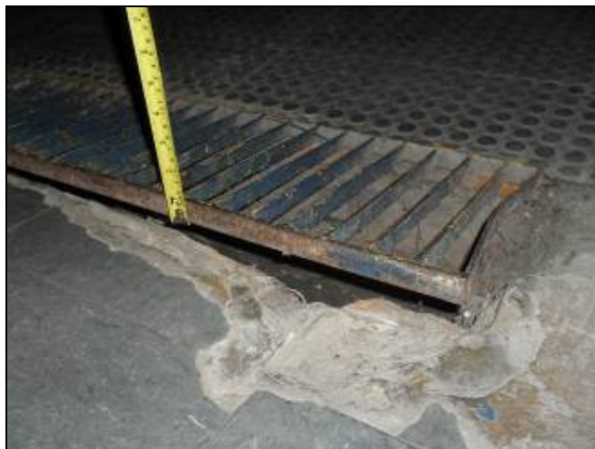
Figura 08. Grelha sem manutenção. Fonte: Arquivo pessoal, 2010.
